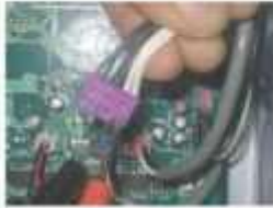
Invertör kompresörü deşarj sıcaklığı sensörünün direncini kontrol edin
